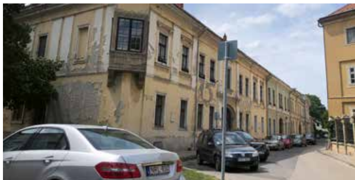
Az önkormányzati épületek állapotfelmérése jelenleg is zajlik a Szent István téren
